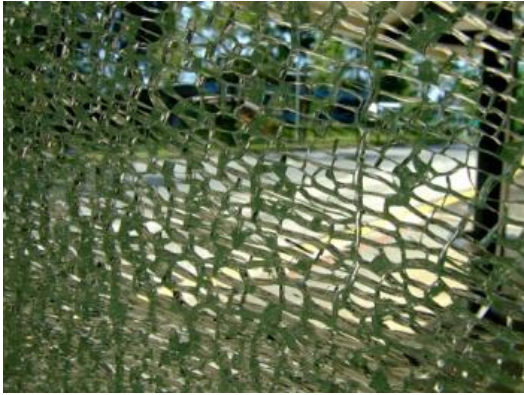
Verre « trempé » proche de la rupture
